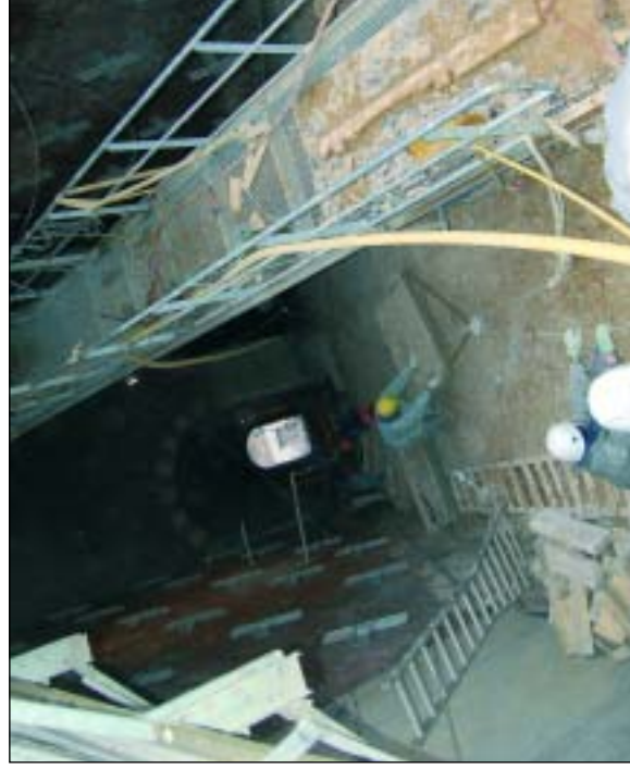
Dans le tunnel, les ouvriers préparent le sol avant la pose des rails
