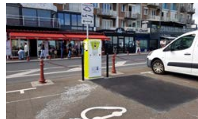
Des bornes pour véhicules électriques
